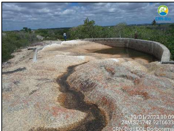
Figura 3.277: Área de acúmulo de água no parque, Pocinhos. Fonte: CRN-Bio, 2023
